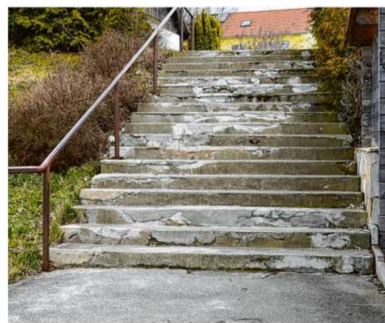
Der obere Abschnitt der Verbindungstreppe weist die stärksten Beschädigungen auf. Foto: Ralf Ott
